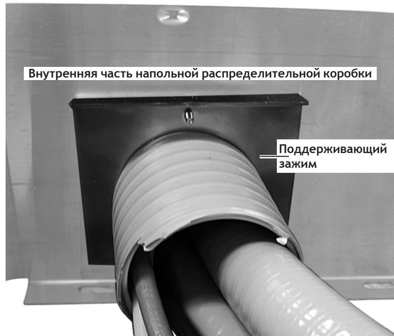
Рисунок 82. Закрепление поддерживающего зажима внутри напольной распределительной коробки
